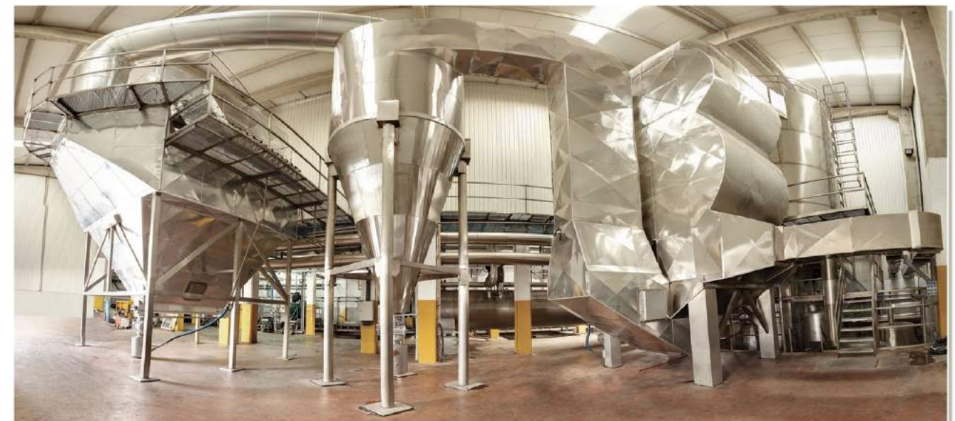
EVSEL VE ENDÜSTRİYEL ATIK SU ÇAMURLARI BERTARAF SİSTEMİ (TESİS İÇ GÖRÜNTÜ) Domestic and industrial waste sludge treatment plant (inside view of facility)
